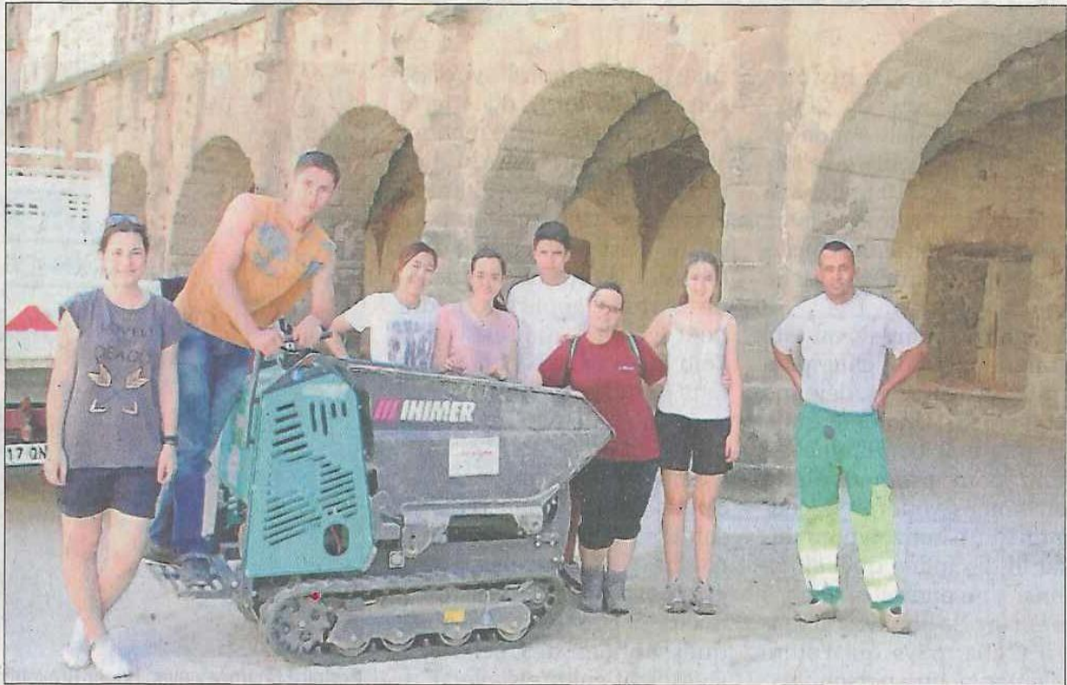
Une partie du groupe du chantier à La Voulte-sur-Rhône. Au total, douze jeunes sont dans cette commune ardéchoise jusqu'au 4 août. Photo DL/Roger MARTINEZ
